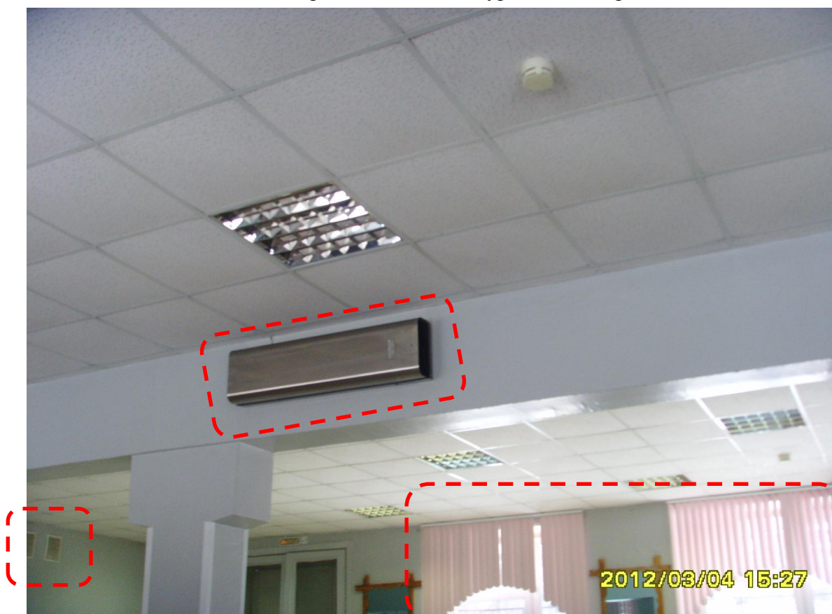
Фото 8-38. Шк. №760. В столовой повесили ламбрекены на окна и недостаток инсоляции пытаются компенсировать агрегатом, размещённым на потолке. Вентиляционные решётки с большими дырочками поменяли на решётки с узкими щёлочками.
