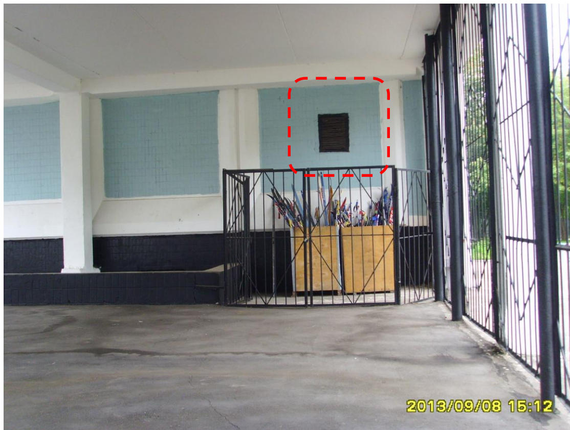
Фото 8-20. Школа №1099. Что это? Похоже на приточный воздуховод. Работает ли?
