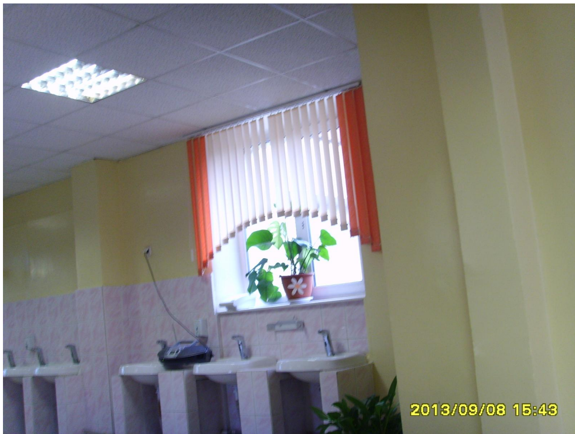
Фото 8-34. Школа 1094. Рядом со столовой. На светопроем повесили дурацкий ламбрекен на подоконник поставили цветок.
