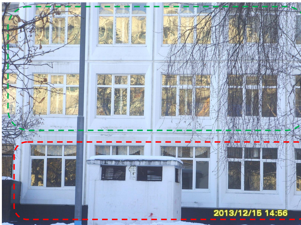
Фото 8-19. Школа №1099. Светопроем в столовой. Есть положительная динамика. Шторы убрали. Остались висеть дурацкие ламбрекены (Север). У физкультурников с головой в порядке (2-3 этаж).
