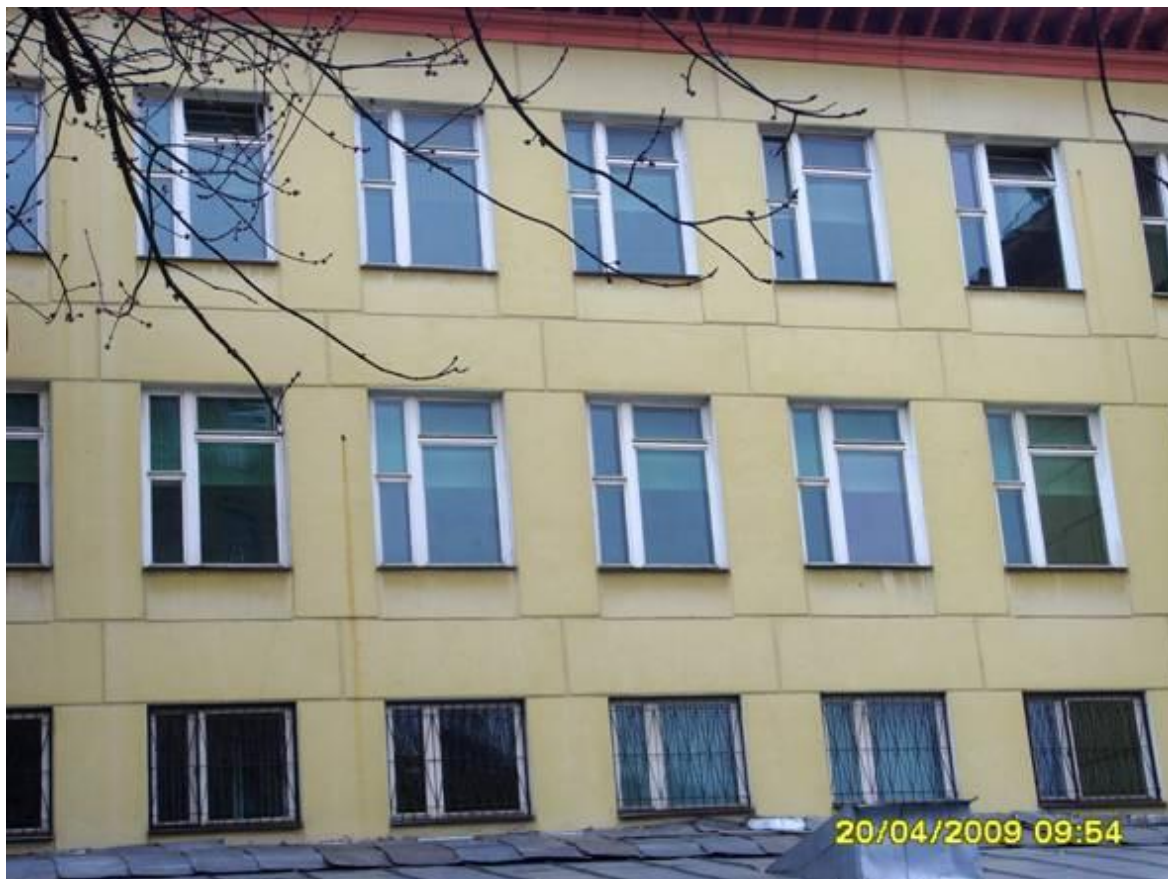
Фото №11. Школа 1226. Светопроёмы в рекреацию завешены дурацкими ламбрекенами. Стёкла имеют зеленоватый отлив.
