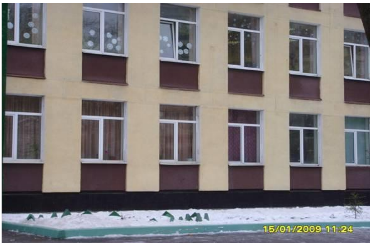
Фото №6. Школа 1094. Светопроёмы в холе на входе постоянно перекрыты тряпками. Рамы без фрамуг.
